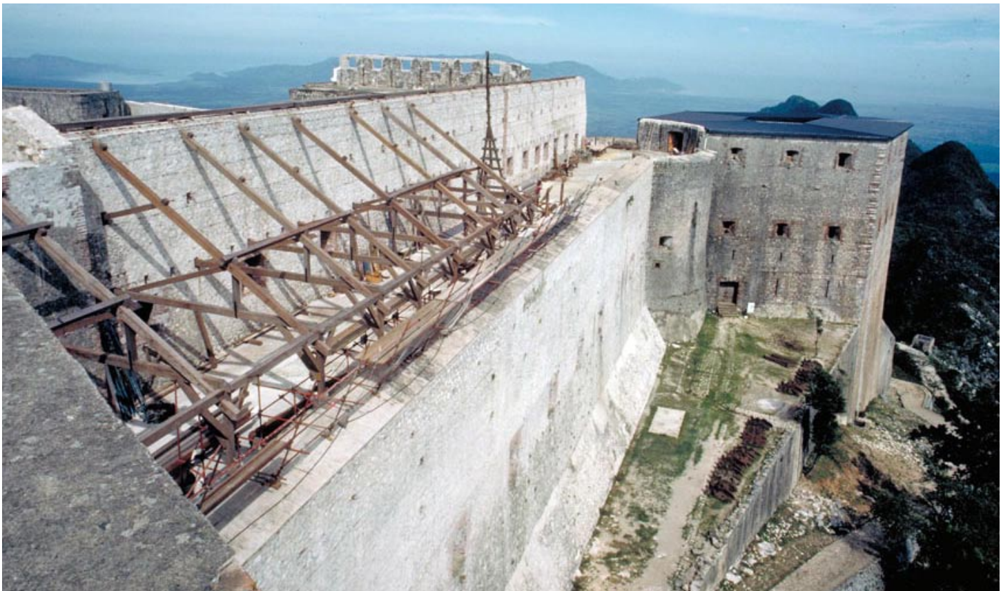
• Pose de la charpente de la Batterie Royale de la Citadelle Henry
